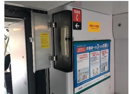
電車内インターホン
