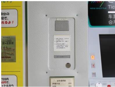
駅務室インターホン
